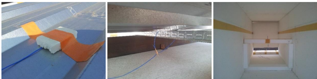
ภาพที่ 3 - 8 การติดตั้งอุปกรณ์เก็บข้อมูลที่ผิวด้านบน ช่องว่างใต้หลังคา และภายในกล่อง
