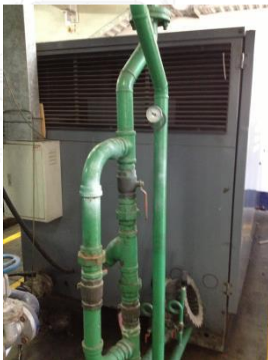
รูปที่ 4.17 เครื่องอัดอากาศ (Air Compressor) เครื่องที่ 8 Atlas cooper GA-1408W (Rotary Screw)
