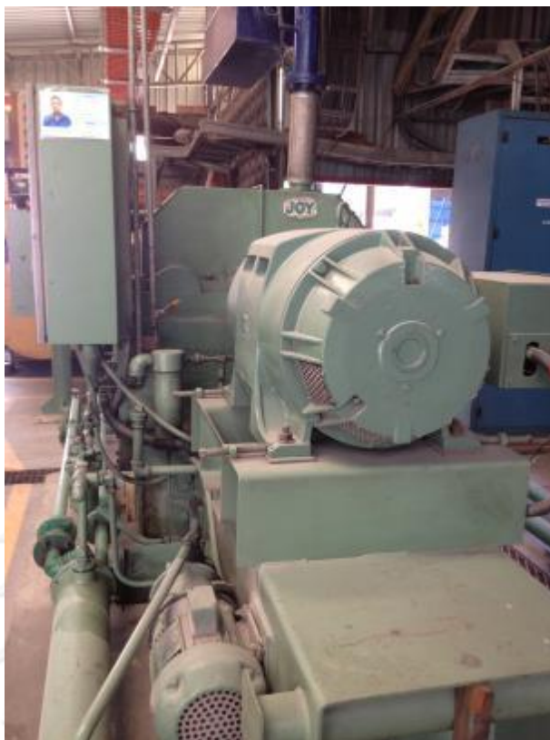
รูปที่ 4.18 เครื่องอัดอากาศ (Air Compressor) เครื่องที่ 9 JOY TA-18 (Turbo)
