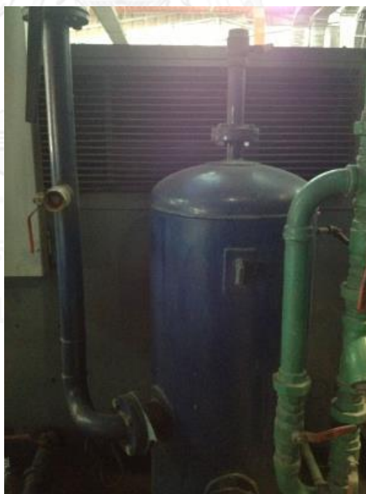
รูปที่ 4.15 เครื่องอัดอากาศ (Air Compressor) เครื่องที่ 6 Atlas cooper GA-1408W (Rotary Screw)
