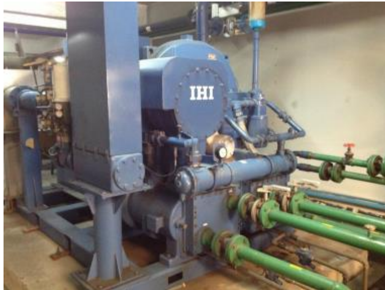
รูปที่ 4.26 เครื่องอัดอากาศ (Air Compressor) เครื่องที่ 17 IHI Tx-A200 (Turbo)
