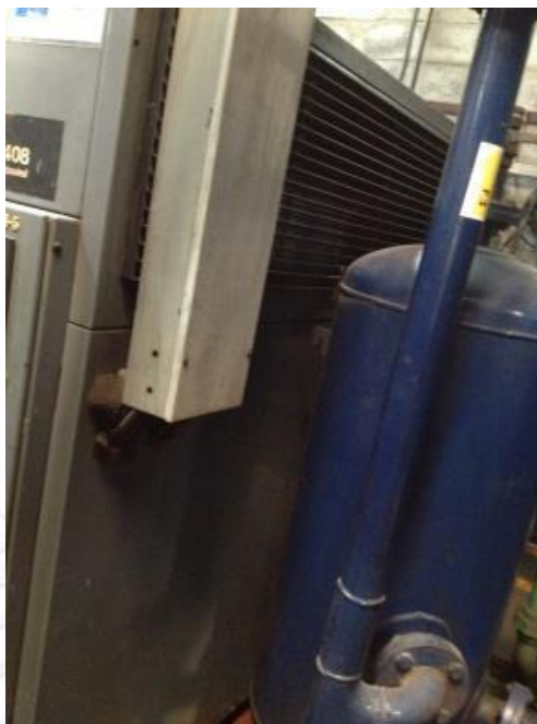
รูปที่ 4.14 เครื่องอัดอากาศ (Air Compressor) เครื่องที่ 5 Atlas cooper GA-1408W (Rotary Screw)
