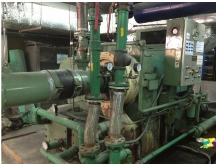
รูปที่ 4.12 เครื่องอัดอากาศ (Air Compressor) เครื่องที่ 3 JOY TA-38 (Turbo)
