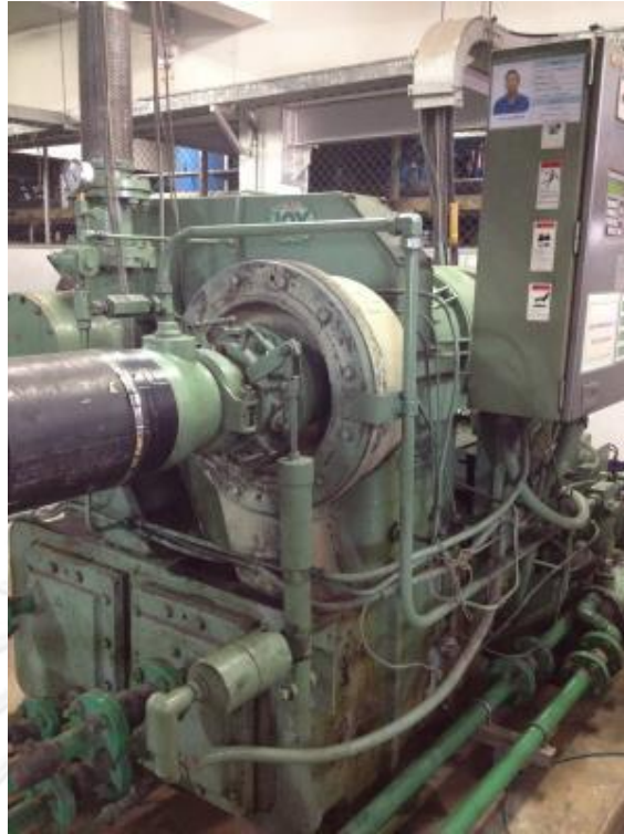
รูปที่ 4.20 เครื่องอัดอากาศ (Air Compressor) เครื่องที่ 11 JOY TA-18 (Turbo)
