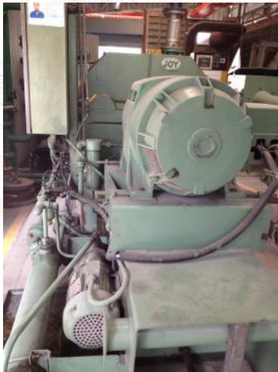
รูปที่ 4.21 เครื่องอัดอากาศ (Air Compressor) เครื่องที่ 12 JOY TA-18 (Turbo)
