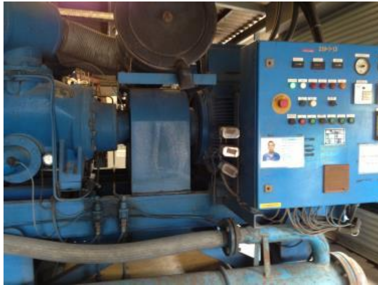
รูปที่ 4.22 เครื่องอัดอากาศ (Air Compressor) เครื่องที่ 13 DEMAG ROW-600 (Rotary Vane)
