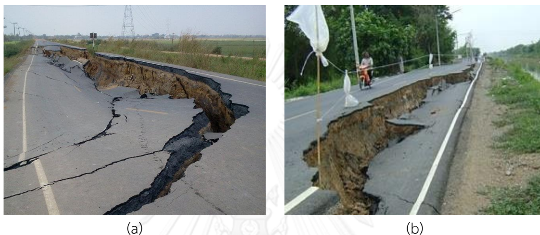
รูปที่ 1.1 การทรุดตัวของถนนบนชั้นดินอ่อน (a) บางปะหัน ออยุธยา (b) คลองหลวง ปทุมธานี
