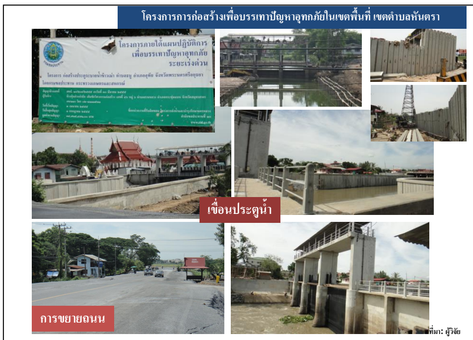
โครงการก่อสร้างเพื่อการพัฒนาและป้องกันอุทกภัยในเขตตำบลหัตตรา
