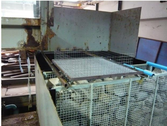
รางเลื่อนวางตะแกรงดักหินท้ายรางน้ำ
