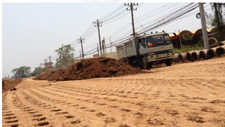
รูปที่ 5.1 รถบรรทุกดินเข้าสู่พื้นที่ก่อสร้าง
