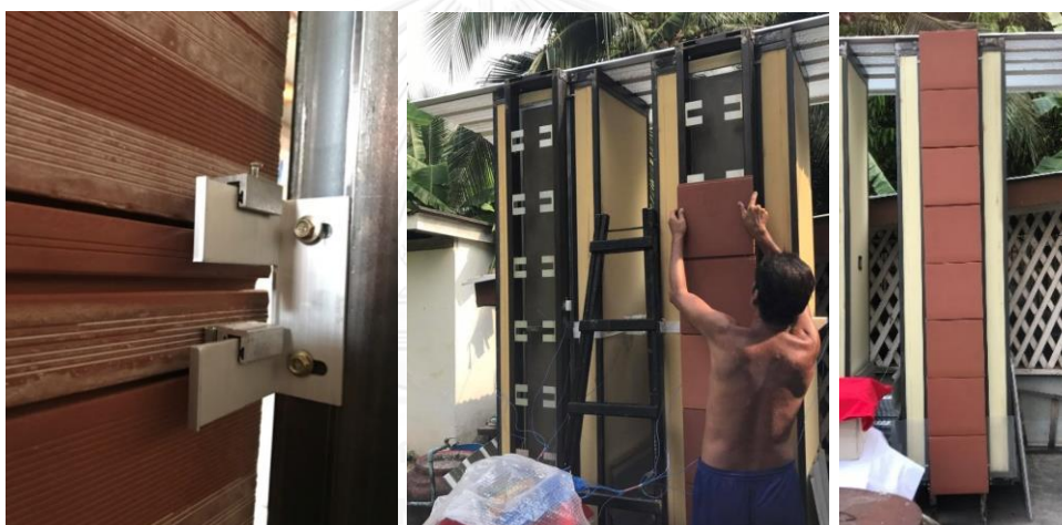
ภาพที่ 3.10 การติดตั้งผนังทดสอบ และผนังทดสอบกับกล่องทดลองที่ทำการติดตั้งเรียบร้อยแล้ว (ตามลำดับ)
