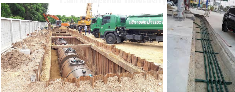
ภาพที่ 2- 10 ตัวอย่างการติดตั้งถังน้ำมันใต้ดินและท่อส่งน้ำมัน
