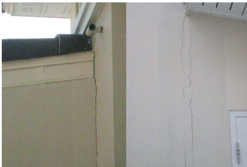
ภาพที่ 6.1 แสดงปัญหาการแตกร้าวที่เกิดขึ้นบริเวณรอยต่อระหว่างอาคาร
