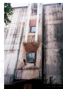
ริมอาคารบริเวณช่องท่อ
