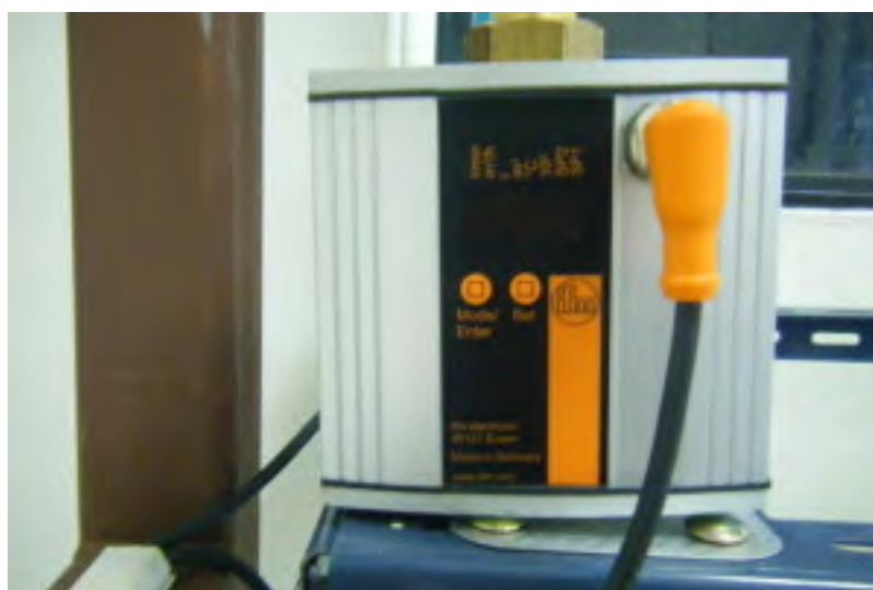
รูปที่ 4.5 มิเตอร์วัดปริมาณน้ำ (Flow meter)
