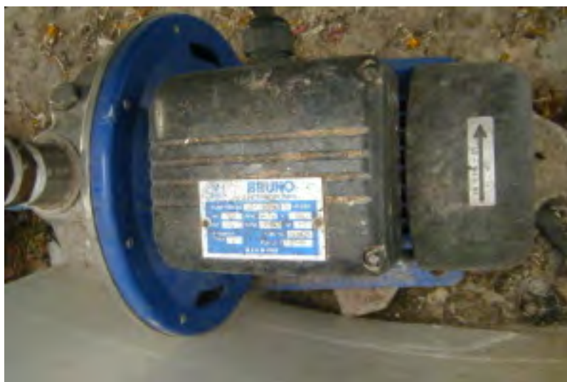
รูปที่ 4.6 ปั้มน้ำแบบแรงเหวี่ยงหนีศูนย์กลาง (Centrifugal Pump)
