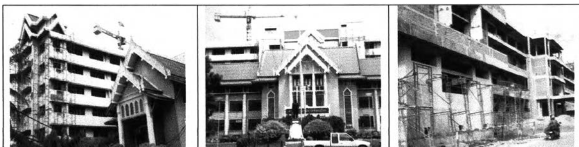
ภาพประกอบ 3.38 การต่อเติมอาคารศาลากลางหลังใหม่ อาคาร 7 ชั้น ด้านหลังอาคาร 3 ชั้นเดิม
