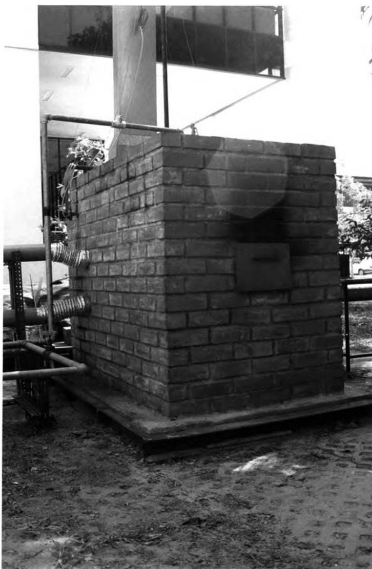
รูปที่ 4.13 แสดงภาพถ่ายด้านหลังของ หม้อไอน้ำแรงดันต่ำโดยใช้เหง้ามันสำปะหลังเป็นเชื้อเพลิง
