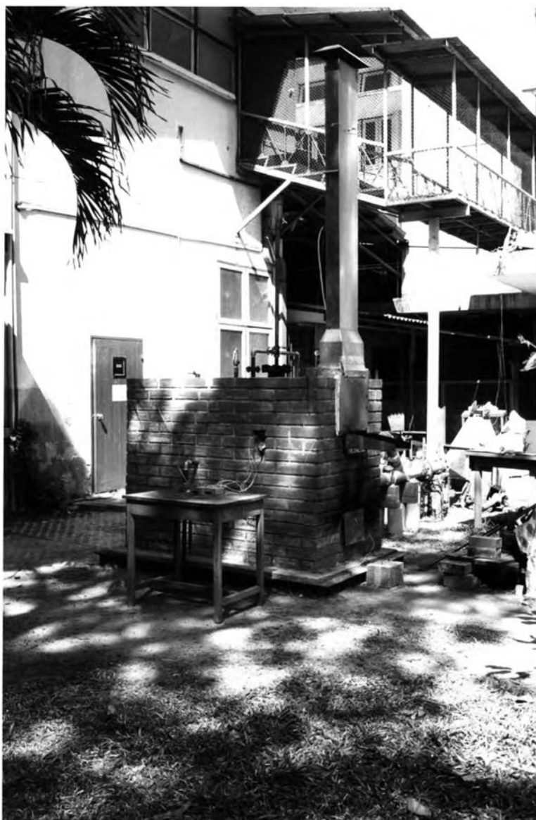
รูปที่ 4.12 แสดงภาพถ่ายด้านข้างของ หม้อไอน้ำแรงดันต่ำโดยใช้เหง้ามันสำปะหลังเป็นเชื้อเพลิง
