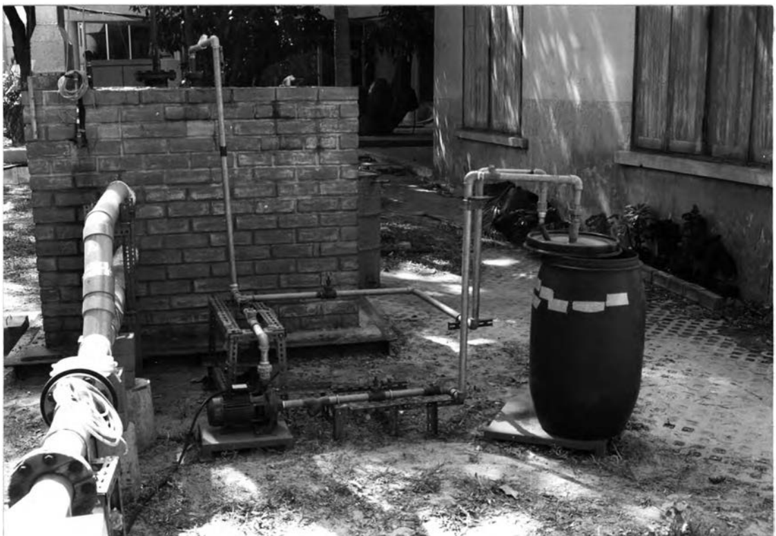
รูปที่ 5.6 แสดงชุดอุปกรณ์ควบคุมระดับน้ำในหม้อไอน้ำ
