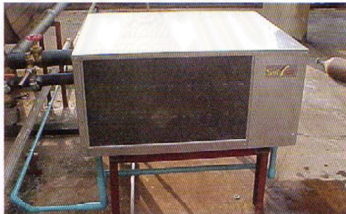
รูป ข.15 แสดงการติดตั้งปั้มน้ำร้อน
