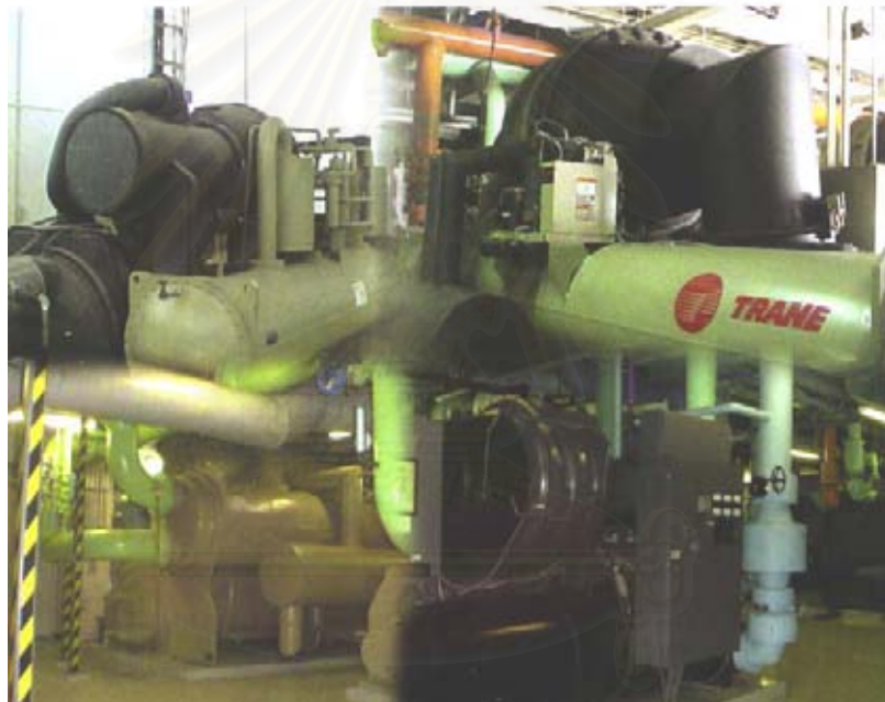
รูปที่ ข.4 การใช้เครื่องทำน้ำเย็นประสิทธิภาพสูง (High Efficiency Chiller)
