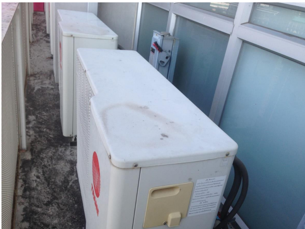
รูปที่ 3 เครื่องปรับอากาศแบบแยกส่วน คอยล์ร้อน ห้องเรียน 709 และ 711
