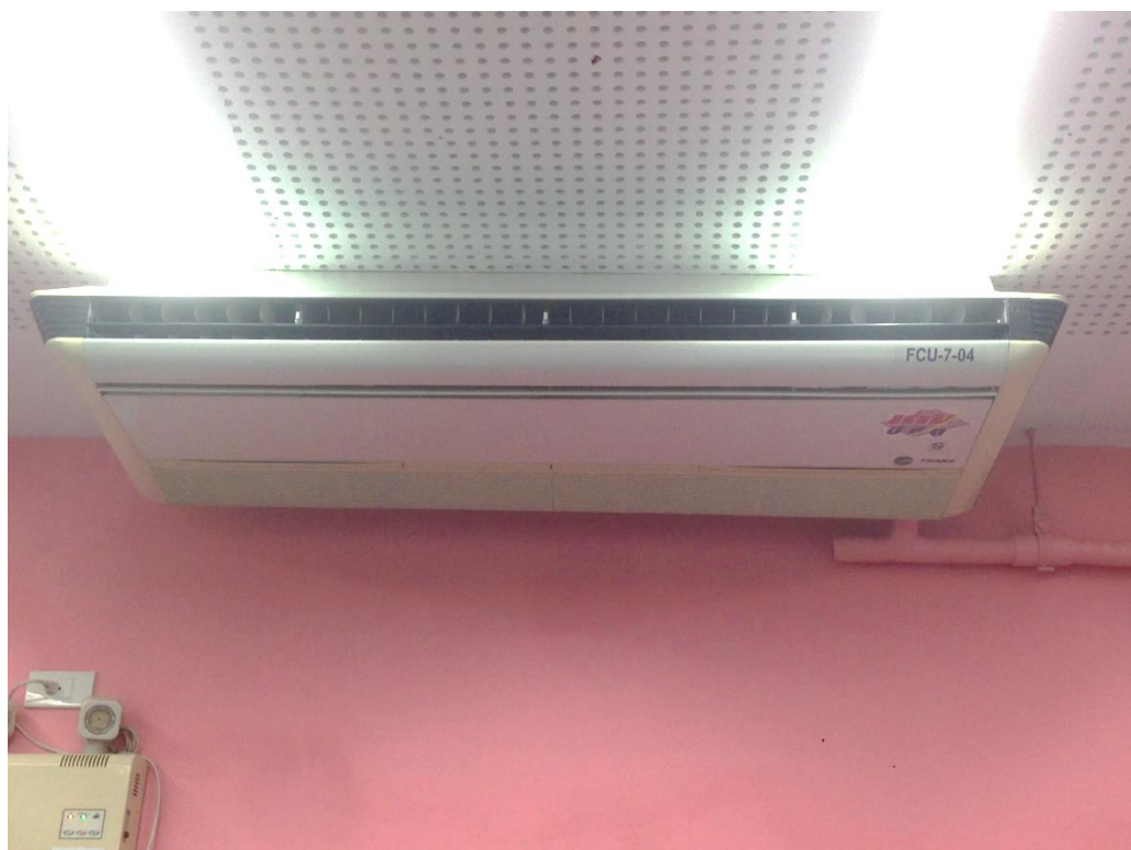
รูปที่ 2 เครื่องปรับอากาศแบบแยกส่วน คอลย์เย็น ห้องเรียน 711
