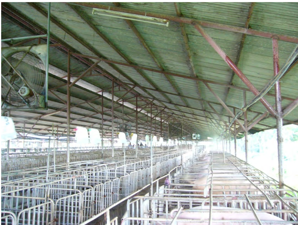
รูปที่ 25 พัดลมและน้ำฝอยในโรงเรือนสุกรอุ้มท้องฟาร์ม B
