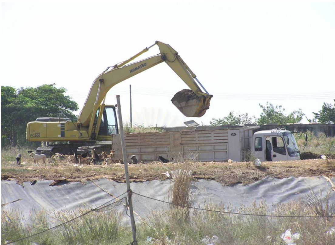
รูปที่ ง.13 แสดงการขนดินของรถ Backhoe และรถบรรทุกของทม.เพชรบูรณ์
