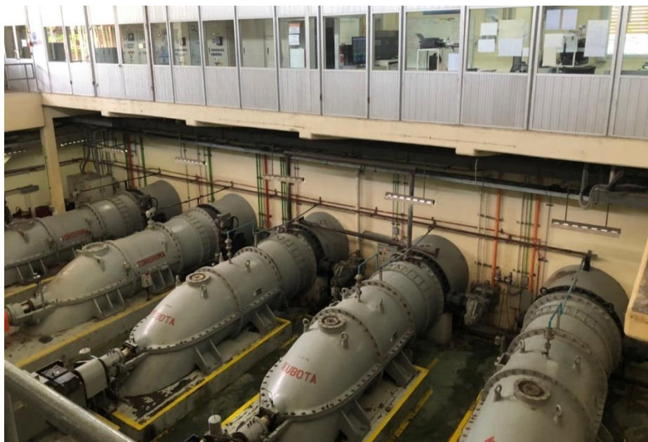
ภาพที่ 14 เครื่องสูบน้ำชนิด Horizontal Axial Flow
