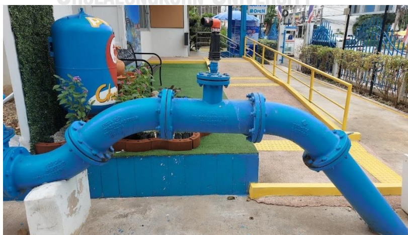
ภาพที่ 55 ท่อจ่ายน้ำ
