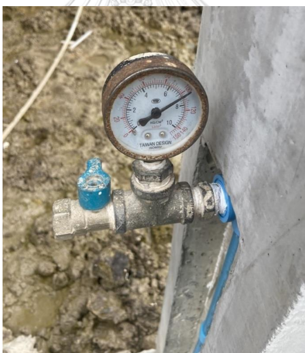
ภาพที่ 57 เครื่องวัดแรงดันน้ำประปาเข้าตัวบ้าน ที่มา: สุวีวรรณ์ ลิมปชัย
