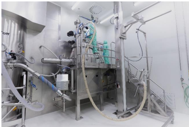
รูปที่ 9 ท่อที่ใช้ในการนำส่งแกรนูล เชื่อมต่อกับระบบ Vacuum transfer system
