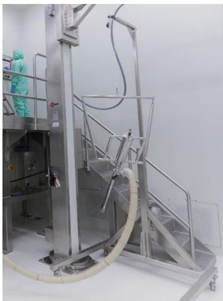
รูปที่ 4 เครื่อง Lump breaker suction lance ใช้ในการลดขนาดก้อนยาเมตฟอร์มีน และนำส่งไปยังเครื่อง High shear granulator
