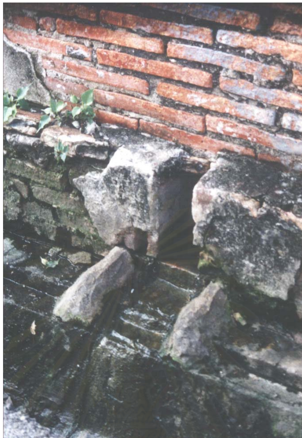
ภาพที่ 84 รางระบายน้ำจากภายในอาคารแบบตะวันตก ถนนนางงาม
